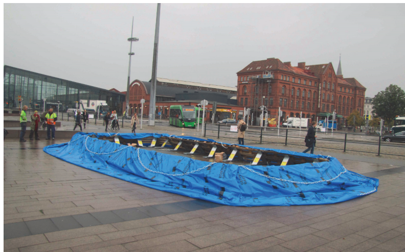
Stormskydd monterade vid Anna Lindhs plats (foto: Malmö stad, gatukontoret).
