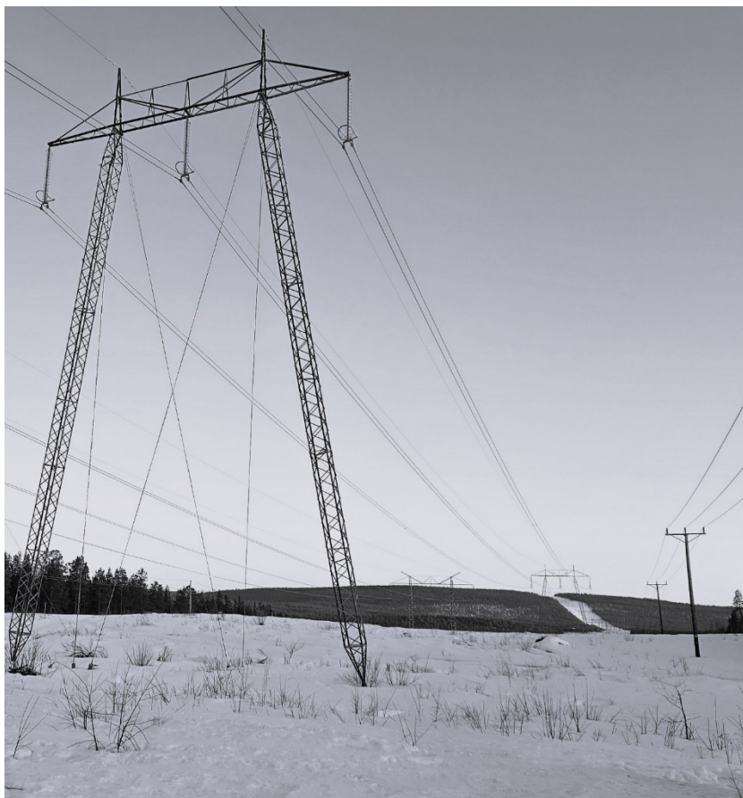
Figur 6 Högspänningsledning 400 kV som för kraften och vinsterna från Lule älv, mot södra Sverige
